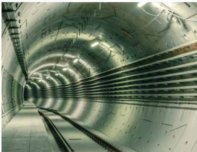
Réalisation de voussoirs de tunnel préfabriqués en béton de fibres en acier, Doha Metro, Qatar.
